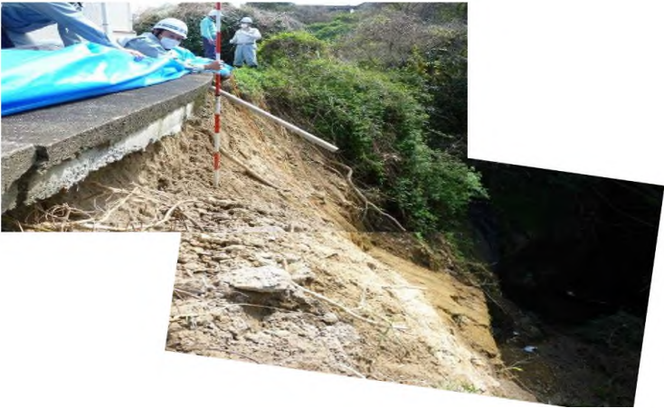
写真-1 崩落箇所の全景写真-撮影日:令和5年3月31日
