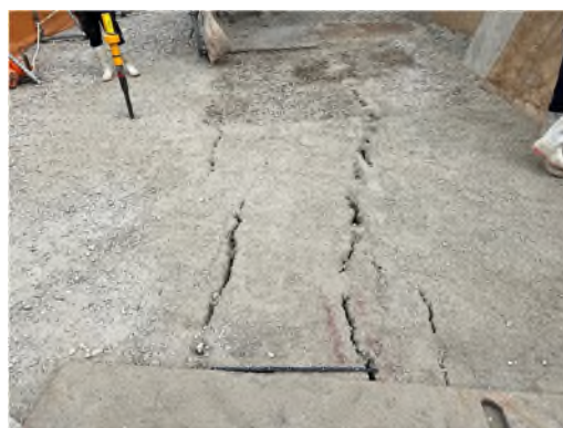
写真-4 地表クラックの状況 撮影日:令和7年7月11日
