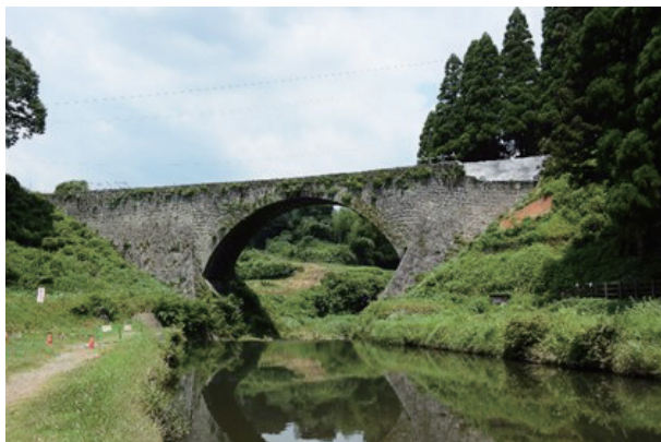
写真-1 通潤橋の被災（右アバット部）
