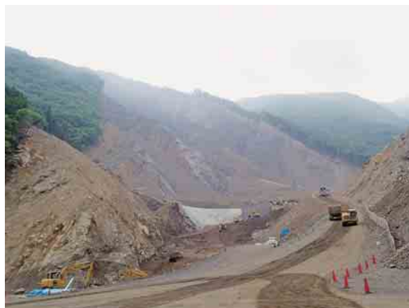
崩壊地全貌（赤谷）
