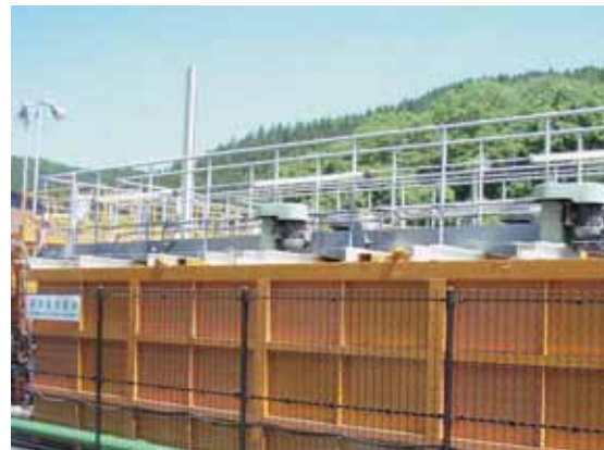
図2 坑道の湧水の処理施設
