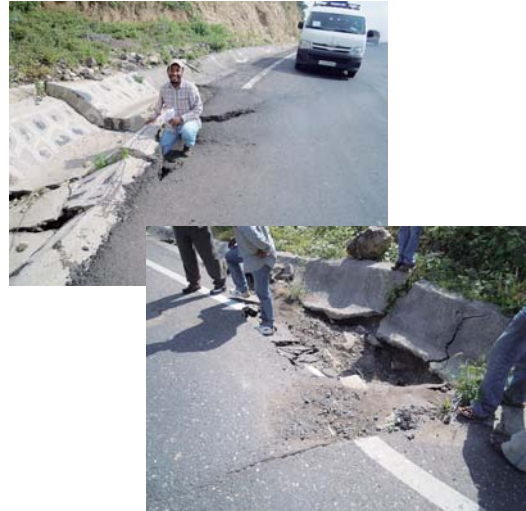
写真-1. 地すべり活動による道路の破損状況
