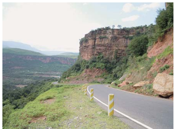
写真-4. 調査地内を通過する道路の状況 地すべりや落石による被害が大きい
