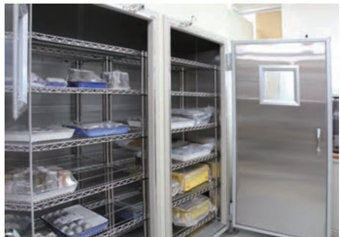
写真－ 2 恒温恒湿室内部
