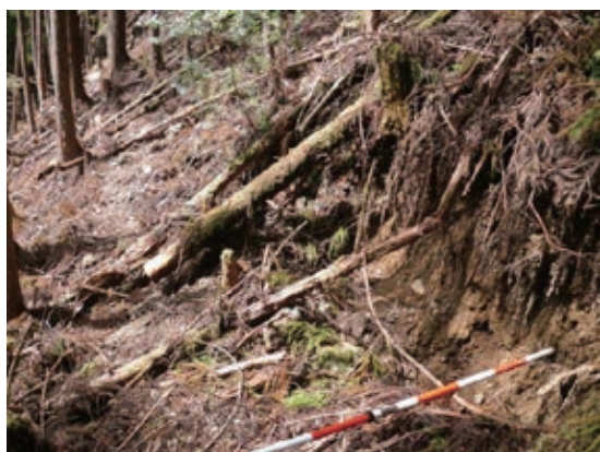
写真 4.2 滑落崖上部の地表の段差
