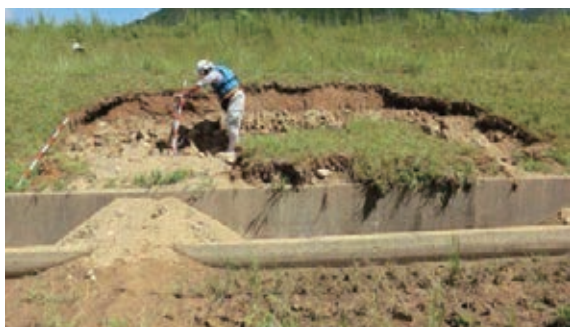
写真-1 被災状況(土堤の洗掘)
