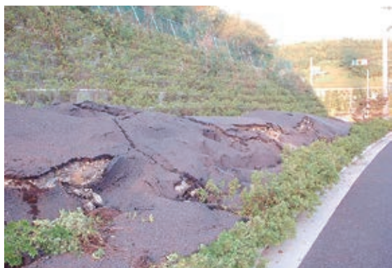
写真-1 1.6m盛り上がった歩道
