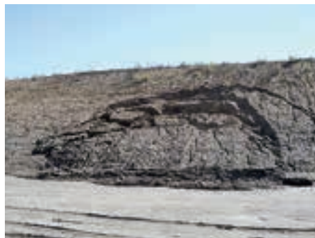
のり面勾配 1:3.0 でも地すべり発生！
