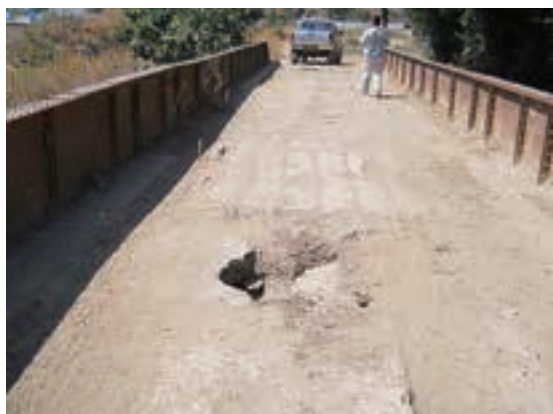
床版に穴がある橋梁も現役！
